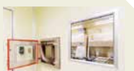
物品の受け渡しを行うパスボックス。 危険な病原体を室外に漏出させない二重扉を採用している
